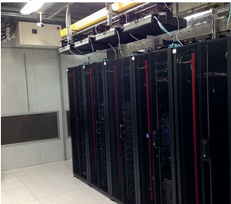
▲ Рис. 4. Воздухозаборные решетки системы охлаждения расположены в нижней части помещения
