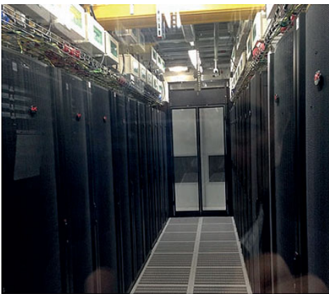
▲ Рис. 3. Холодный воздух нагнетается через фальшпол в холодный коридор
