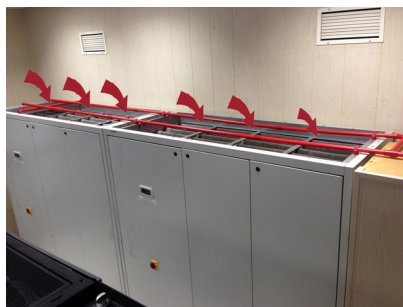
Рис. 7. Контроль на входах горячего воздуха в системы прецизионного кондиционирования
