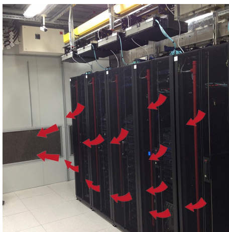
Рис. 8. Контроль на выходе горячего воздуха из активного оборудования
