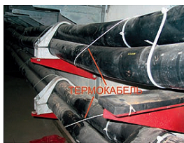
Рис. 5. Высоковольтный кабель и термокабель
