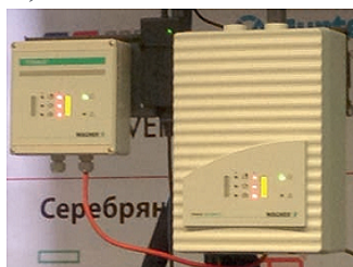
Рис. 3. Обнаружение перегрева кабеля аспирационным извещателем
