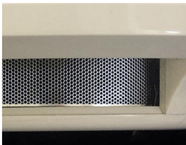
Рис. 7. Защита дымозахода сеткой
