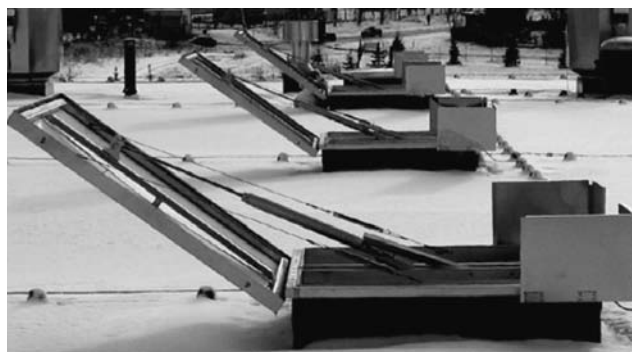
Рис. 3. Дымовые люки на крышах зданий
