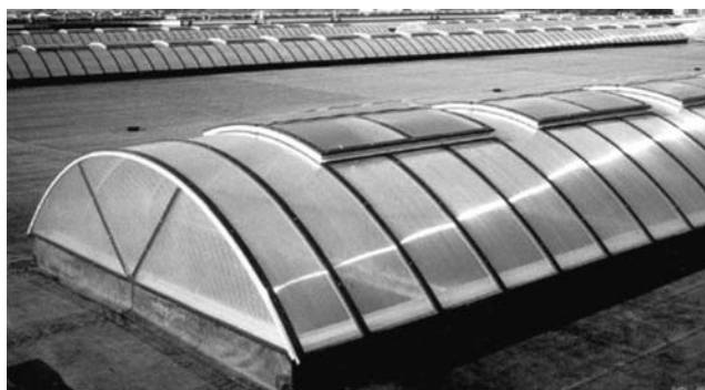
Рис. 2. Двухстворчатые люки дымоудаления на атриумах
