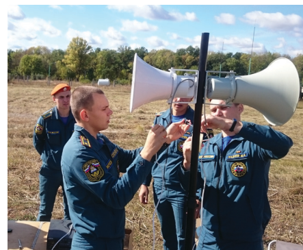
Рис. 4. Монтаж и подключение рупорных громкоговорителей ROXTON HS-50T HP-30T к комбинированной системе
